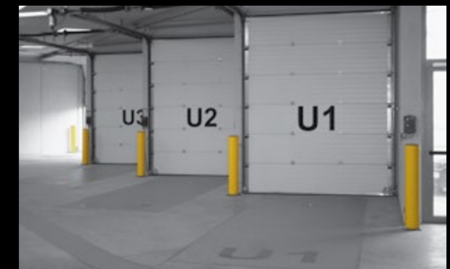
▶ BO Impact / protección de puertas industriales
